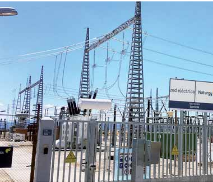
Subestación eléctrica de Lastras del Pozo. EL ADELANTADO
