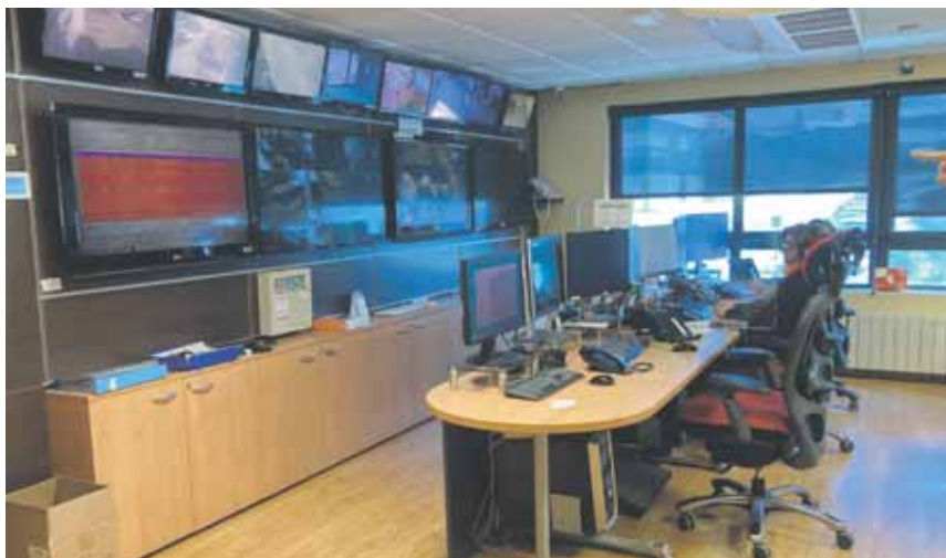
Sala de control de la Central Receptora de Alarmas de Drin Seguridad.
