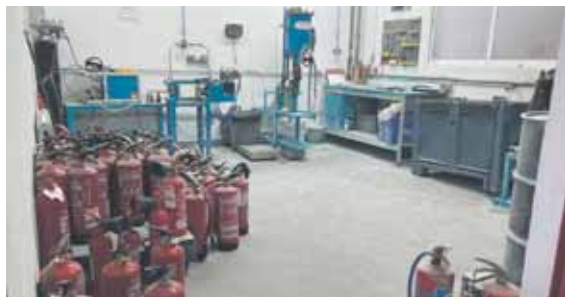
Sala de mantenimiento de extintores.
