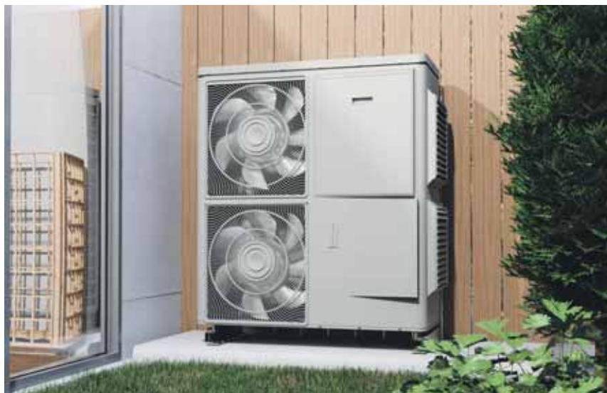
Bombas de calor instaladas fuera de la vivienda.
