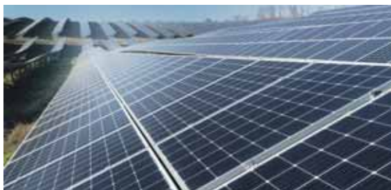
Planta de energía alternativa con paneles solares.
